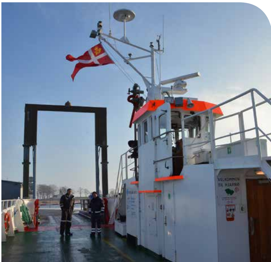
Færgefører Michael Laursen (tv) og overfartsleder Klaus Nissen følger repareratørens arbejde med en defekt ventil på røret til skumkanonen.
